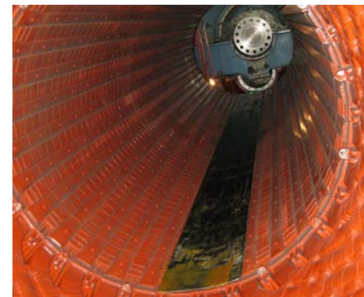
Dichtes Kupfergeflecht: So sieht der Generator von innen aus.
